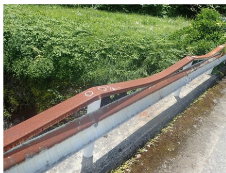
写真-8 防護柵の変形
