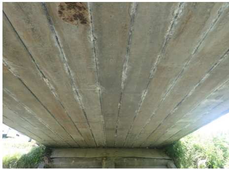
写真-1 PC橋主桁間詰部からの遊離石灰
