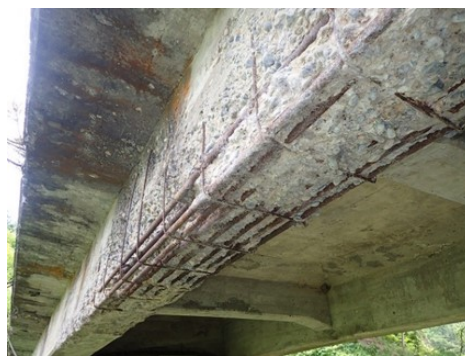
写真-4 RC橋 主桁の鉄筋露出
