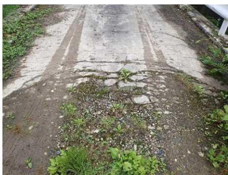
写真-7 舗装のひびわれ
