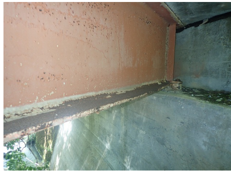
写真-2 鋼桁の塗装劣化
