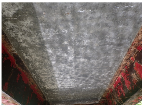
写真-5 RC橋 床版ひびわれ
