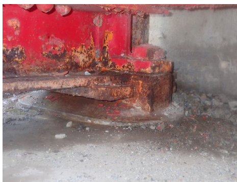
写真-3 支承の腐食
