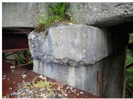
写真-6 下部工のスケーリング
